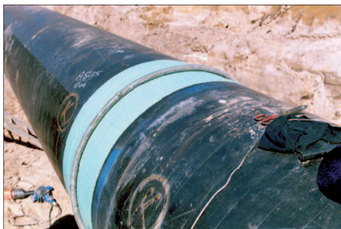
Bild 3: Nicht normungs- und regelwerkskonformer Einsatz von Nachumhüllungsmaterialien: Weichplastisches („viskoelastisches“) Korrosionsschutzband als Schweißnahtumhüllung
