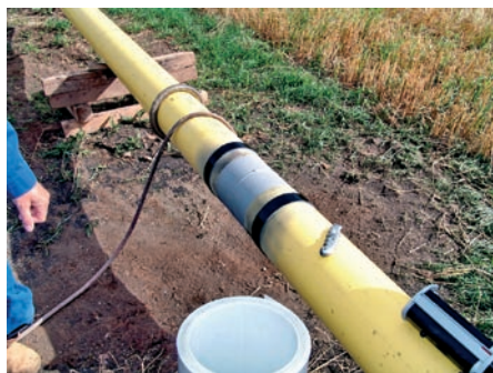
Bild 2: Montage der Abstandshalter beidseitig der Schweißnaht Fig. 2: Spacers mounted on each side of the weld bead
