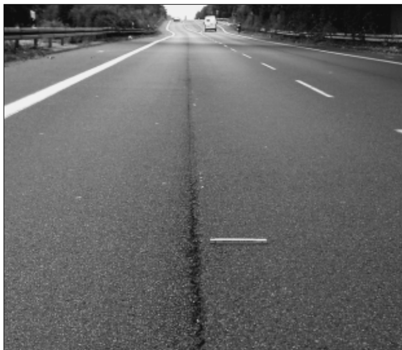
Schaden an einer Naht aufgrund fehlerhafter Nahtvorbehandlung. Fotos: Denso
