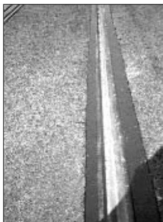
Abbildung 2: Verfüllte Fugen an einer Schiene – breite Außenfuge, und schmale Innenfuge
